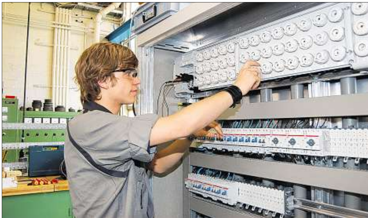
Manuel Willi beim Überprüfen einer Schalt- und Verteilanlage einer Polymerisationsanlage. Bilder Ladina Steinmann
